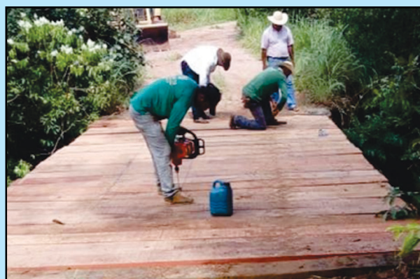
Reforma de ponte no Córrego Mocambo, uma das inúmeras intervenções realizadas nessa área em todas as regiões do município
