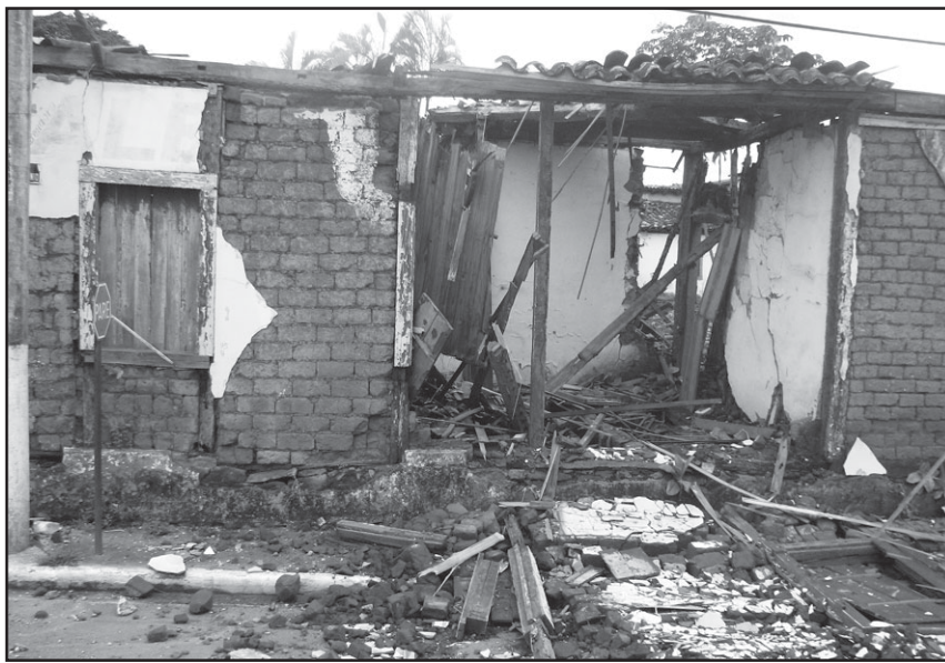
Parte do telhado e uma das paredes do casarão desabaram no dia 18/02.
