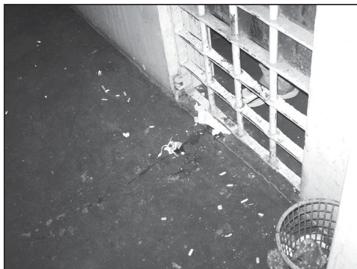
Cadeia de Silvânia: piso e grades em péssimas condições...
