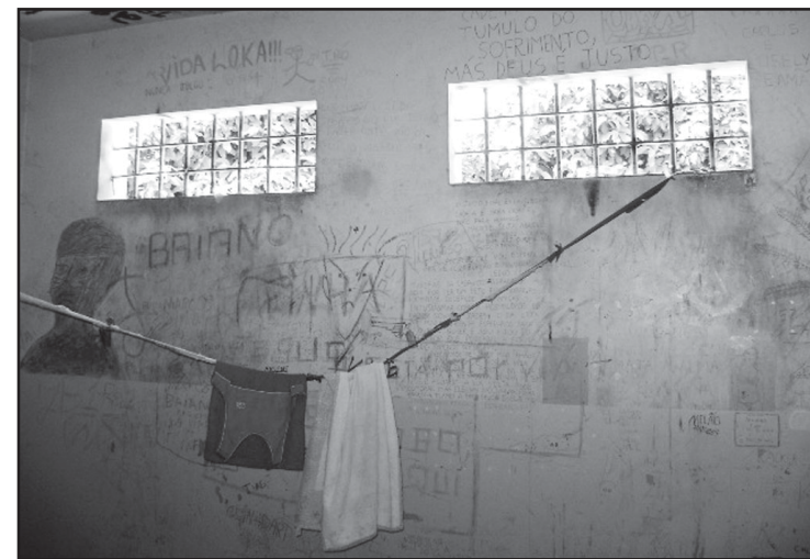
além de paredes que dão aspecto desagradável ao local.
